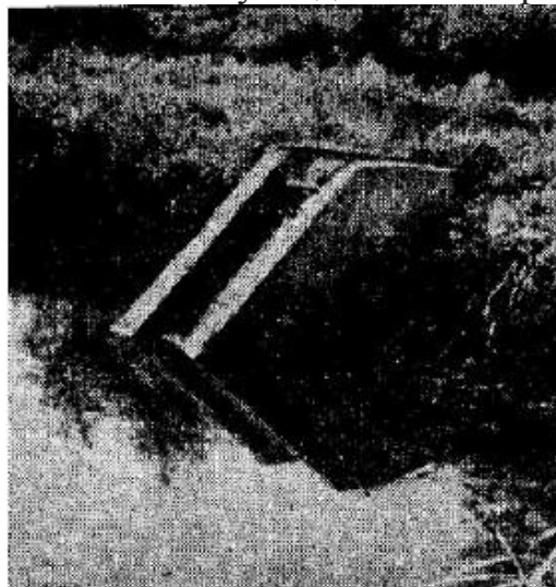
Рисунок 6. Похилий бетонний стояк.
