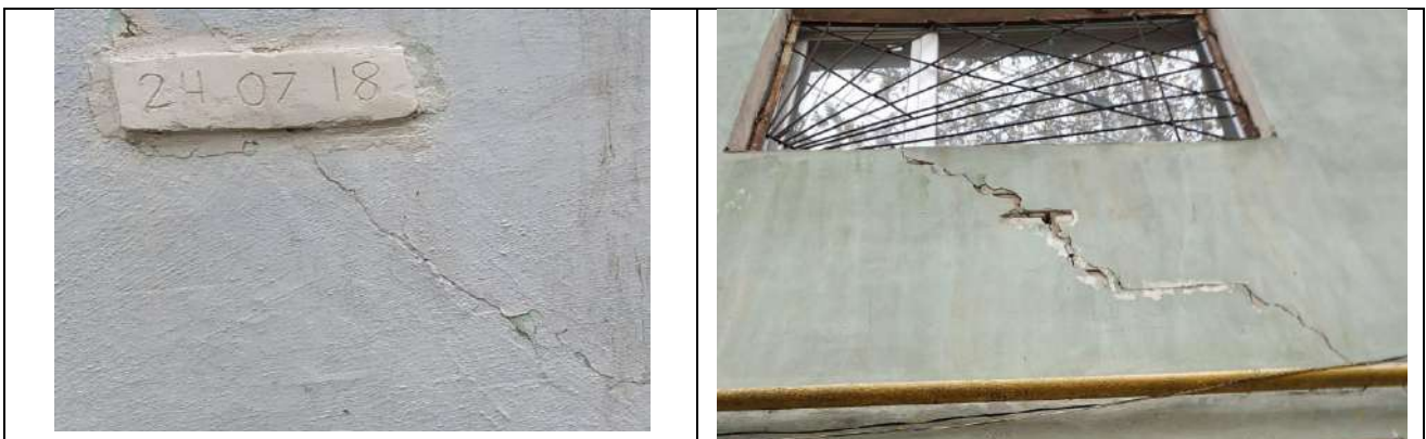
Рисунок 3 – Фіксація розвитку тріщин гіпсовими маяками
