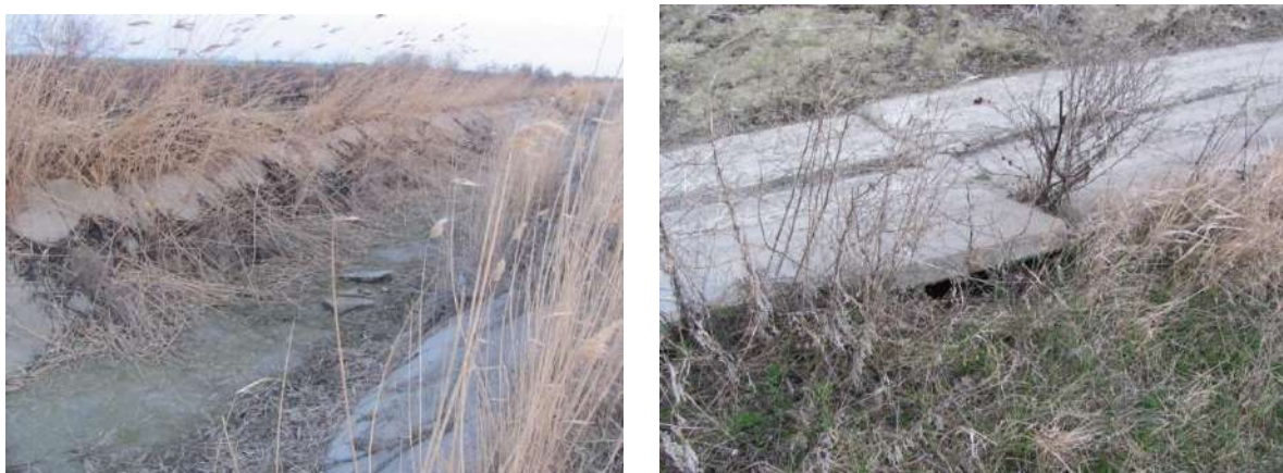
Рис. 1.4 – Стан облицювання каналу Р-1 ПК132- ПК132+300
