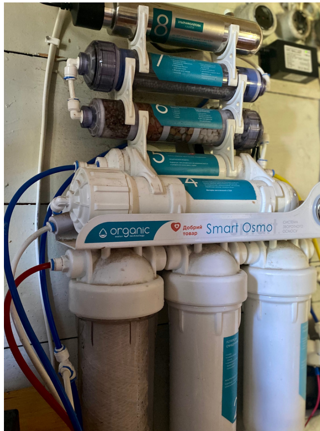
Система очистки води в екоцентрі “Тепла гора” (с. Черетів, Івано-Франківська область)
