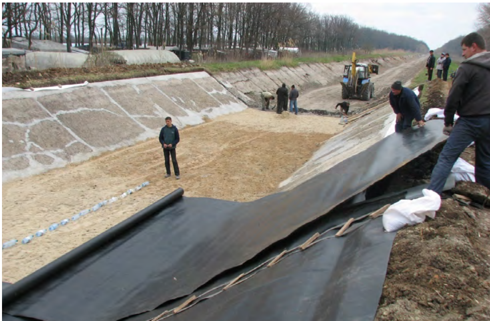
Рис. 1. Процес укладання геомембрани HDPE (поліетилену високої щільності Solmax 440-70007 t = 1 мм) на дослідно-виробничій ділянці Інгулецького магістрального каналу
