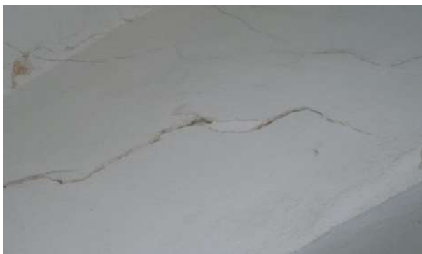
Рис. 4. Похилі тріщини у підвальному приміщенні
