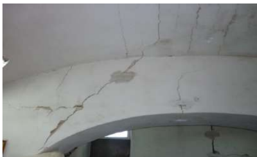
Рис. 9. Нахилені тріщини в кам'яних стінах підвального приміщення
