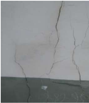
Рис. 7. Вертикальні тріщини розкриті більше зверху
