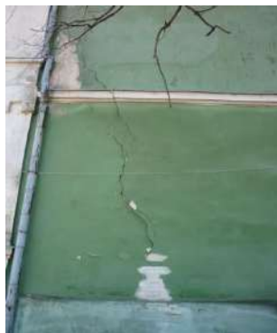
Рис. 11. Вертикальні та косі тріщини вказують на лінійне джерело зволоження вздовж зовнішньої стіни
