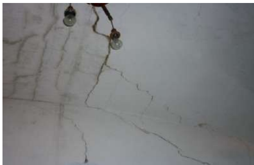
Рис. 3. Вертикальні тріщини у підвальному приміщенні
