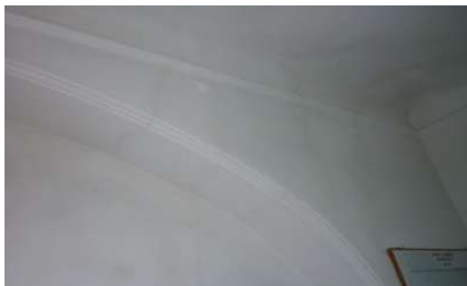
Рис. 10. Волосяні тріщини вказують можливе місце джерела замочування
