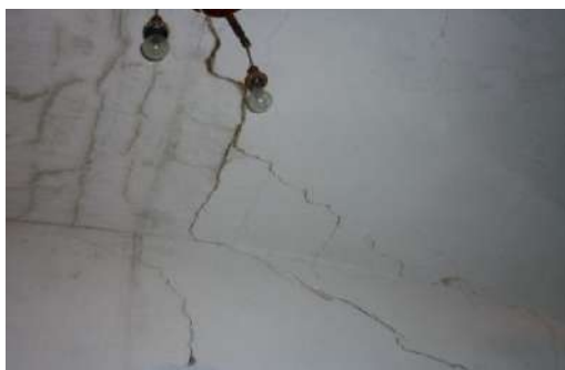
Рис. 3. Вертикальні тріщини у підвальному приміщенні
