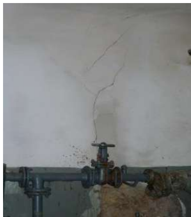
Рис. 8. Сліди замокання на зовнішніх стінах
