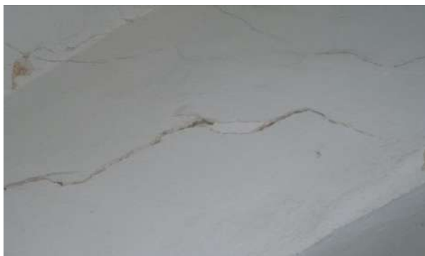
Рис. 4. Похилі тріщини у підвальному приміщенні
