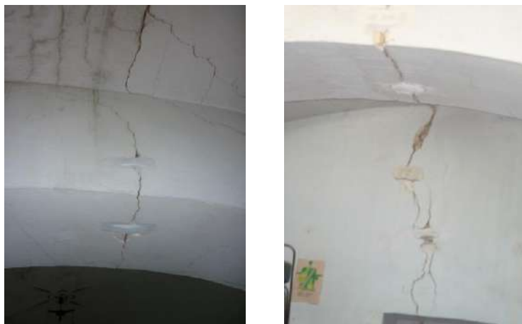
Рис. 5. Наскрізні вертикальні тріщини в несучих арочних конструкціях у підвальному приміщенні
