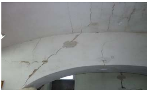
Рис. 9. Нахилені тріщини в кам'яних стінах підвального приміщення
