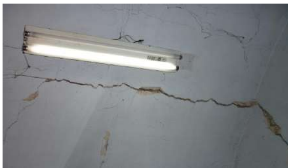
Рис. 6. Поздовжні тріщини у замковому перекритті
