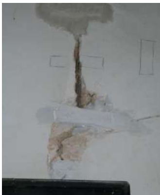
Рис. 12. Прямі тріщини з розкриттям знизу вказує на місто появи джерела замочування
