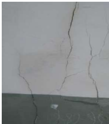
Рис. 7. Вертикальні тріщини розкриті більше зверху
