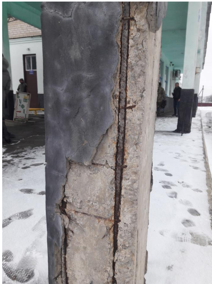
Рис. 1 Загальний вигляд руйнування залізобетонної колони К1
