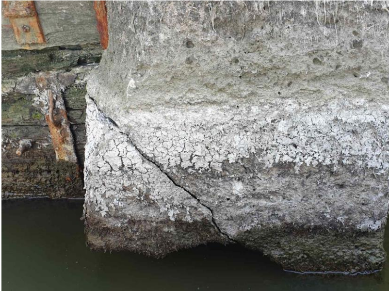
Рис 2. Похила тріщина з наднормативним розкриттям. Бетонні конструкції мають біоушкодження
