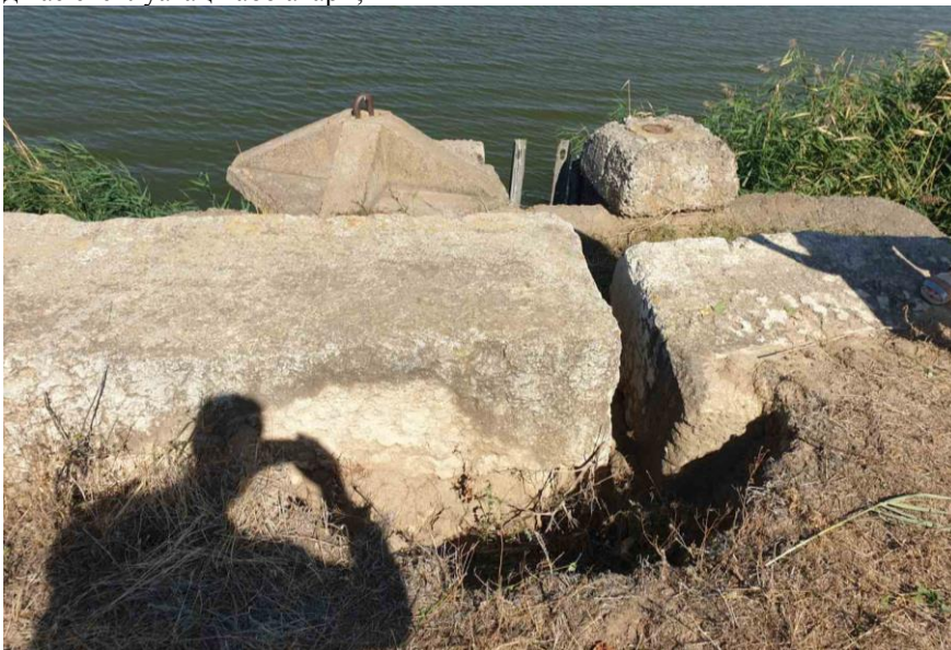
Рис. 4. Відхилення бетонної конструкції від проектного положення в горизонтальному напрямку
