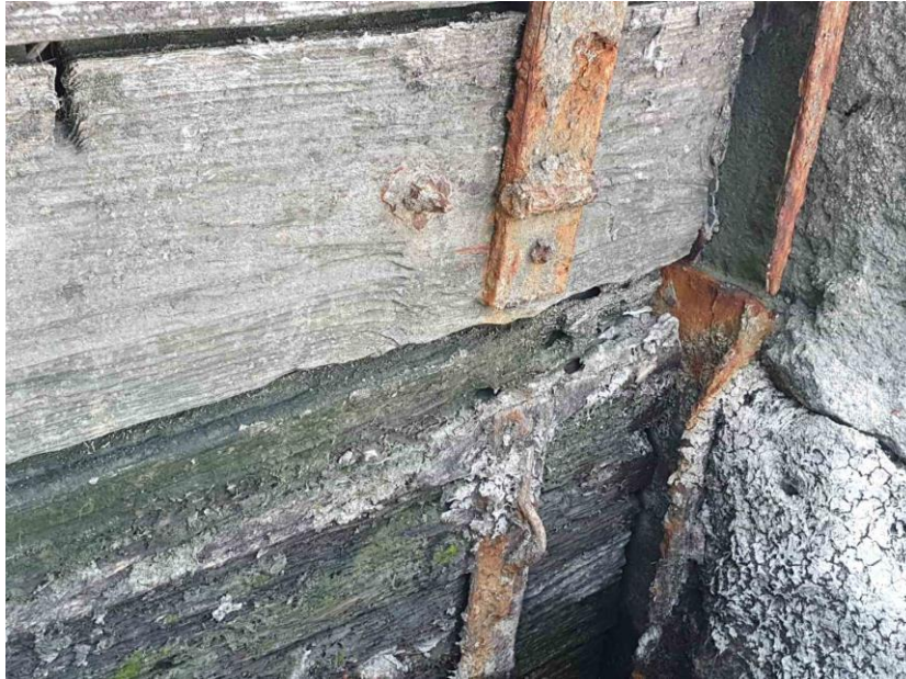
Рис. 3 Конструкція дерев'яного затвору. Сильна корозійна агресивність металевих конструкцій затвору
