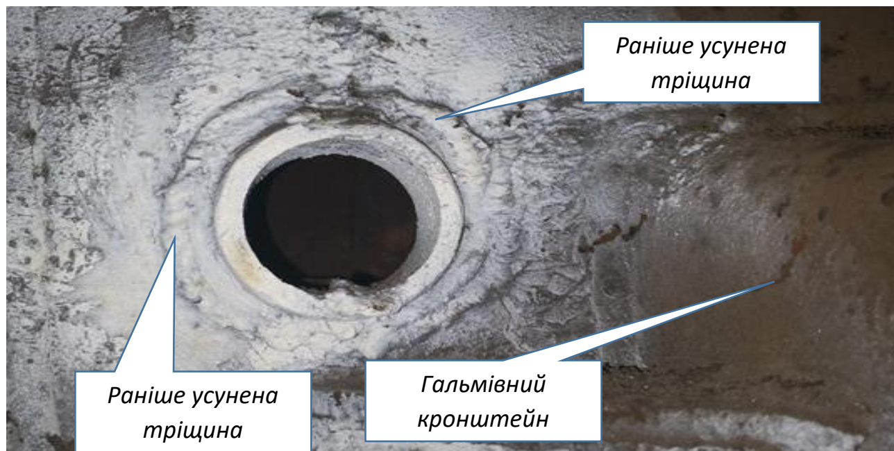
Рис.2. Усунені тріщини у навколошовній зоні отвору стакана.
