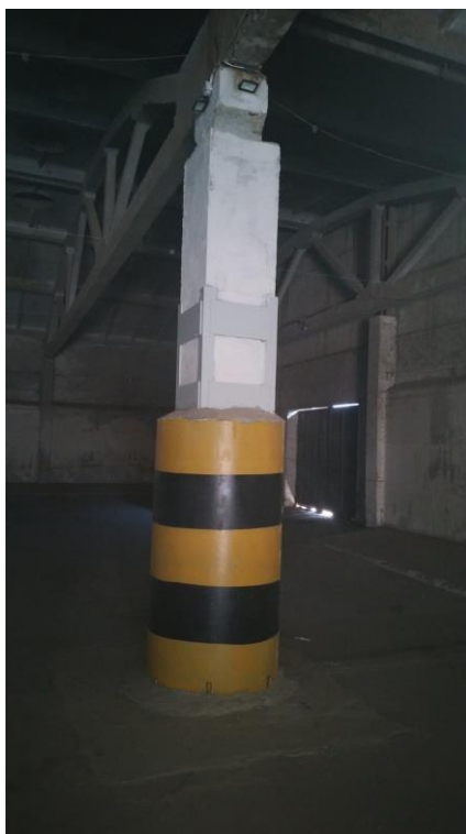
Рис. 4. Загальний вигляд відновленої залізобетонної колони з захисним обрамленням
