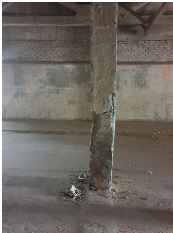
Рис. 1. Загальний вигляд руйнування залізобетонної колони середнього ряду
