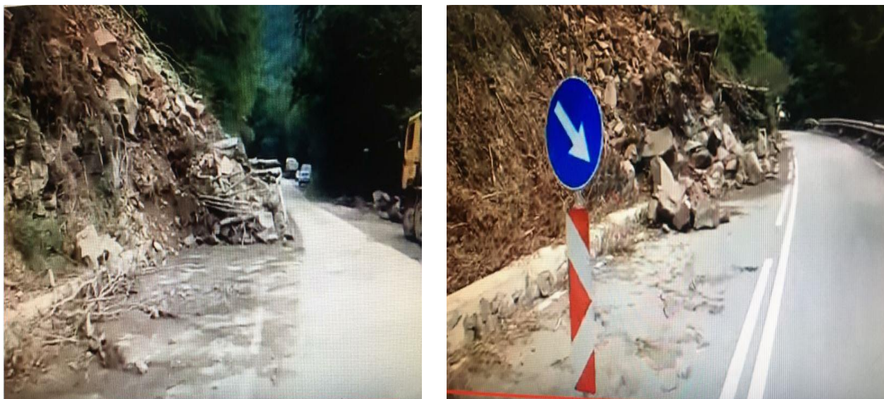
Рис. 2. Примеры обвально – оползневой неустойчивой массы с верхнего склона на проезжую часть дороги на горных дорогах Болгарии
