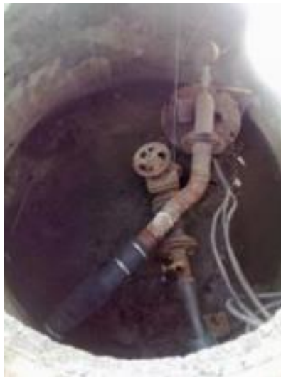
Рис. 5. Технічний стан підземного павільйону: на напірному трубопроводі відсутні зворотній клапан, засувка і лічильник води
