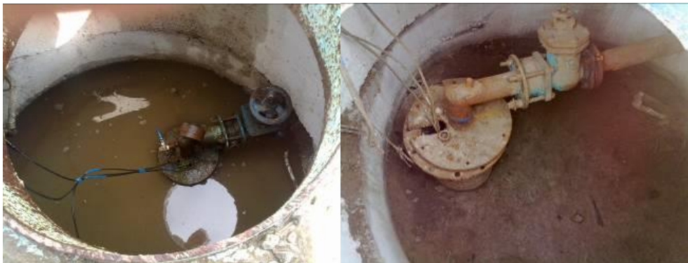
Рис. 3. Технічний стан оголовка і арматури водозаборів № 5-115, 5-110
