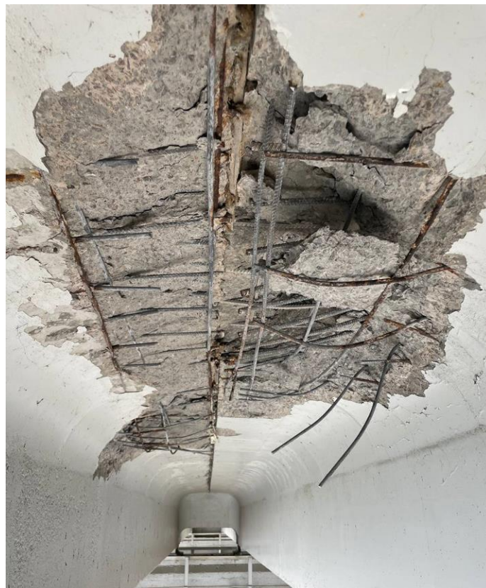
Рисунок 4 – Руйнування плитних частин балок прогону моста, вивал бетону, деформації, погнутість арматури, корозія, тріщини, порушення з'єднань арматури
