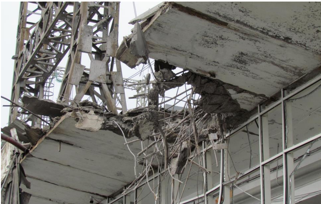
Рисунок 1 – Наслідки ракетного удару, руйнування, пролам консольної частини плити несучого покриття будівлі
