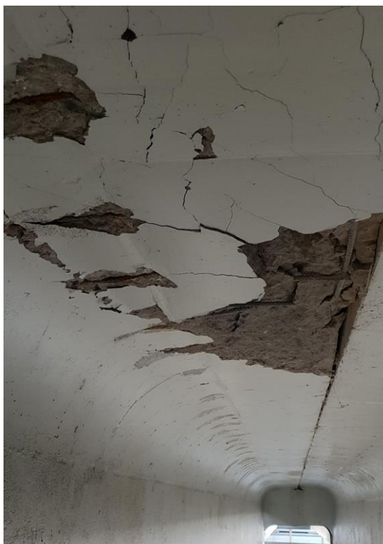
Рисунок 5 – Розгалужена система тріщин, руйнування, сколювання бетону, оголення арматури балки прогону моста
