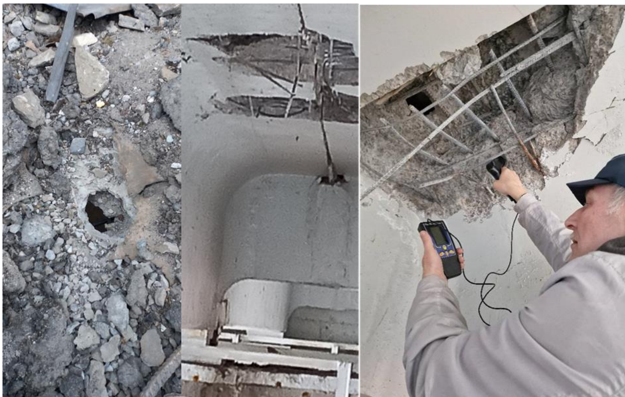
Рис. 2. Типові руйнування залізобетонних балок прогонових будов
