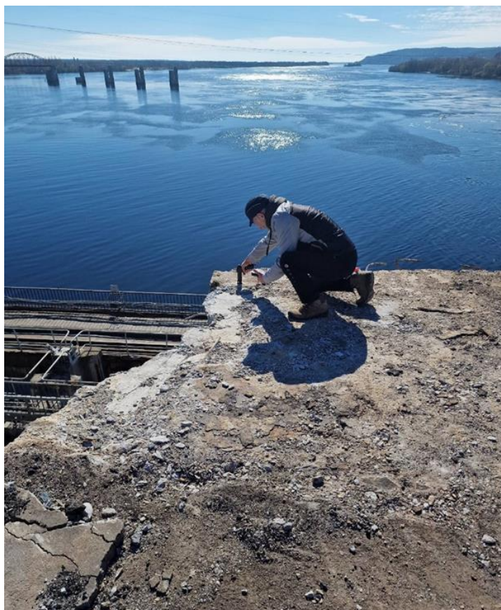
Рис.1. Зруйнована ділянка плити покриття, контроль міцності бетону
