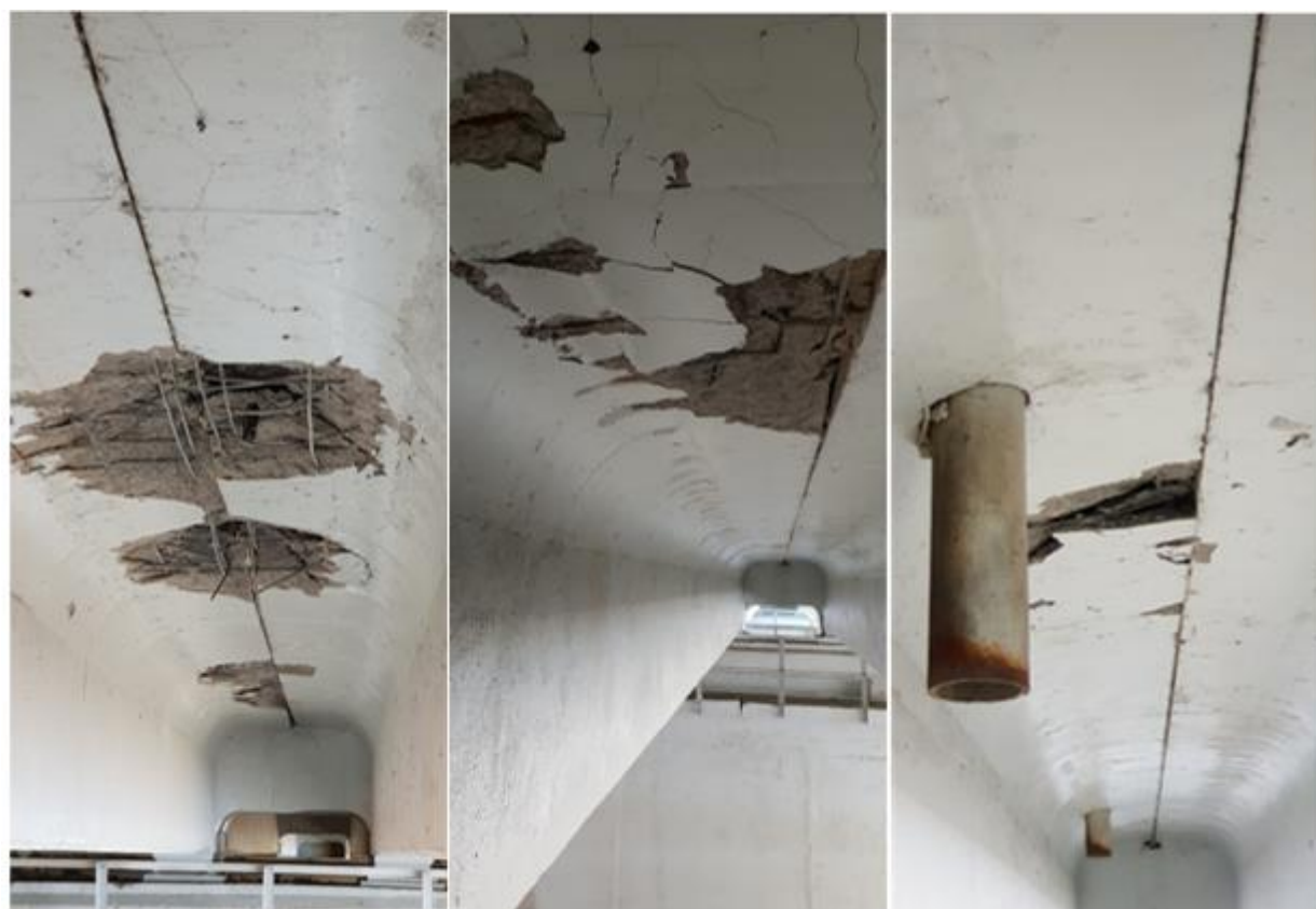
Рис. 3. Фотофіксація руйнувань залізобетонних балок знизу
