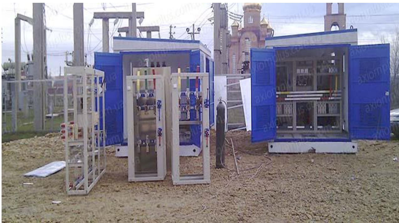
Рис. 1. Загальний вигляд трансформаторної підстанції
