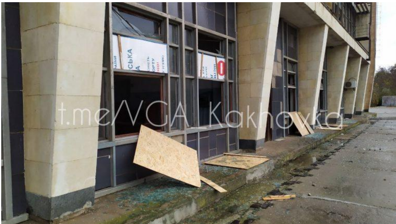
Рис.1. Пошкодження на ГНС УГКМК від обстрілів, 18.11.2022
